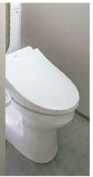
■ トイレ 抗菌仕様の便器に、洗浄便座を 採用。便座を温める機能付。
