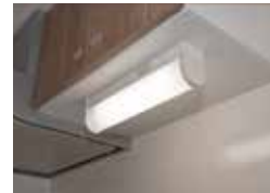
棚下灯 吊戸棚の下には、ワークトップを明るく照らす棚下灯を設置しました。
